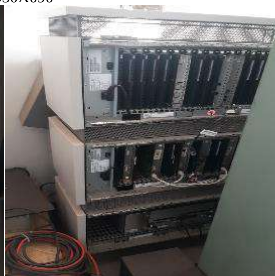
Central telefônica Siemens
