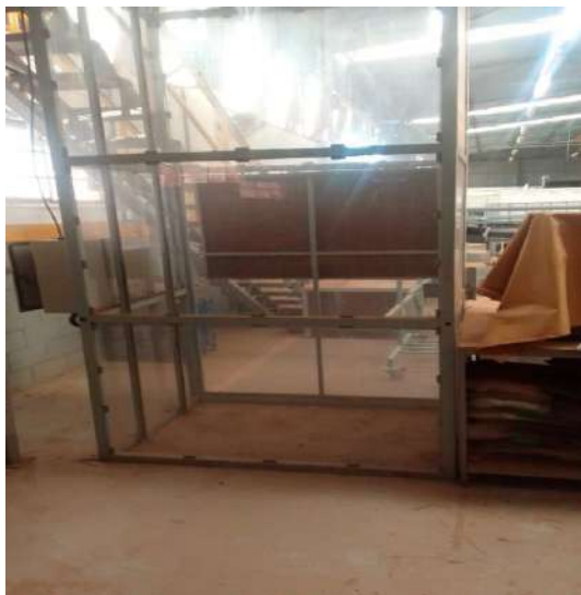
Elevador tipo industrial
