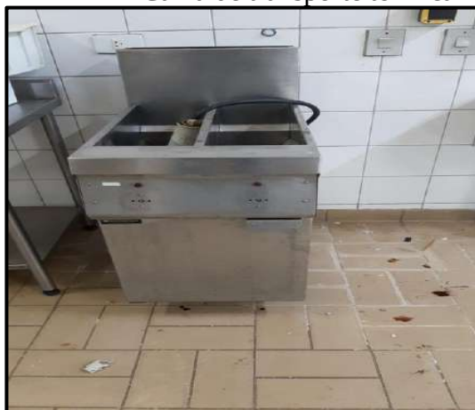
Fritadeira elétrica em inox
