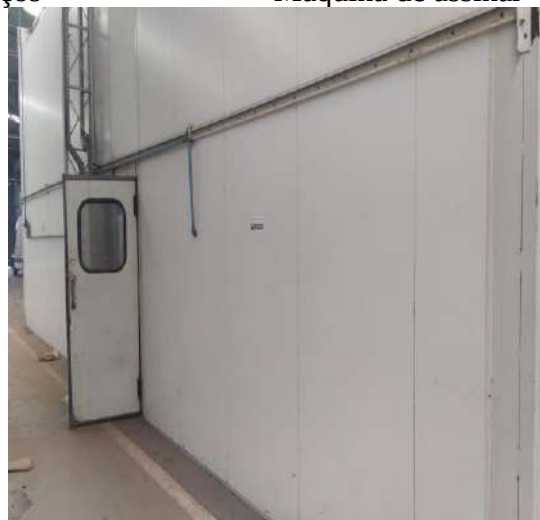
Lateral cabine de pintura
