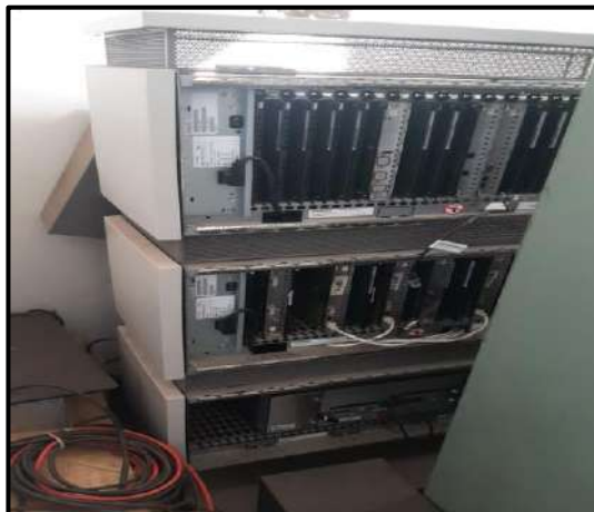
Central telefônica Siemens
