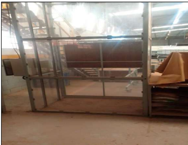
Elevador industrial – Nº bem: 70624
