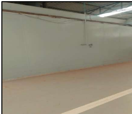
Lateral cabine de pintura
