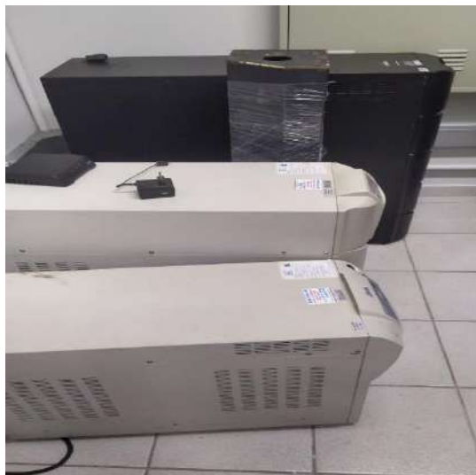
No break com banco de baterias
