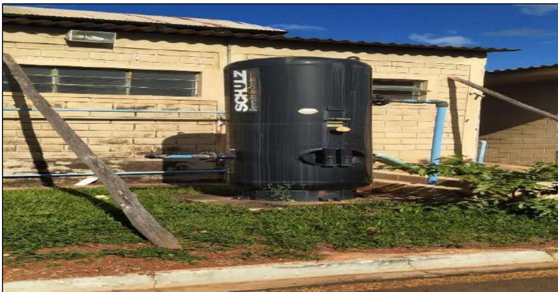
Separador de condensado – N° bem: 50766
