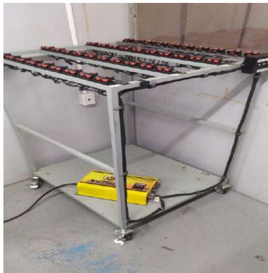
Carro metálico teste de circuitos
