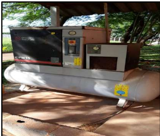
Compressor de ar
