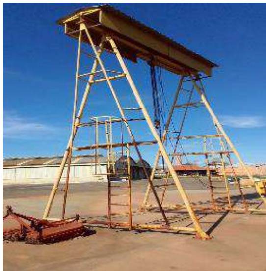
Pórtico com talha
