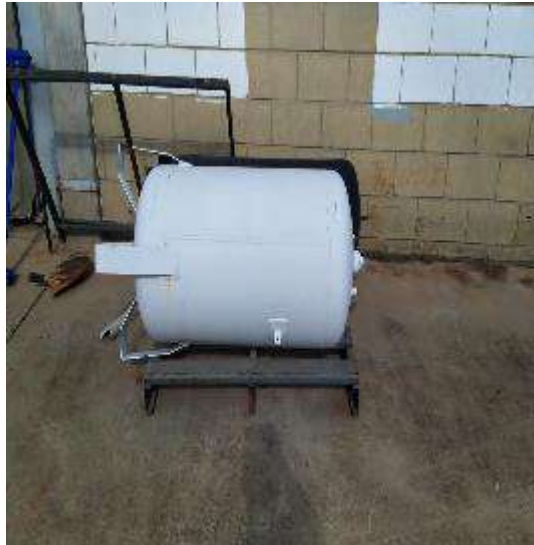
Tanque de gás
