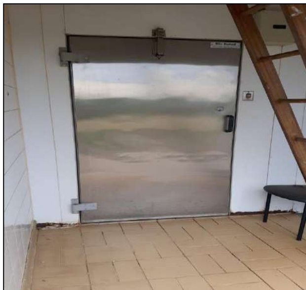
Câmara frigorífica São Rafael – N° bem: 50270
