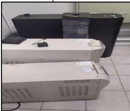
No break com banco de baterias
