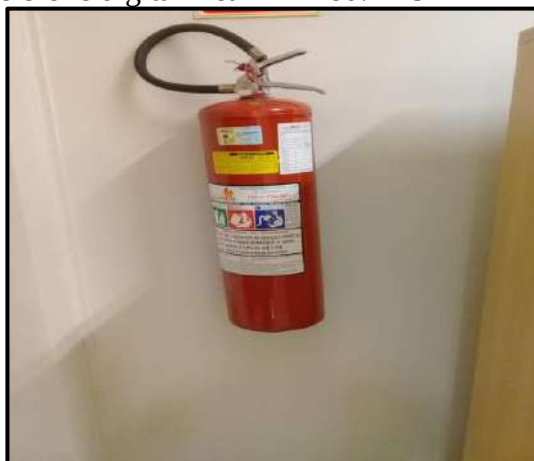
Extintor de incêndio
