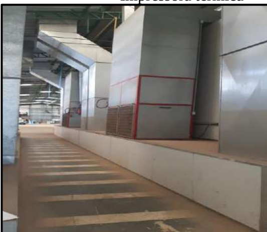
Lateral cabine de pintura
