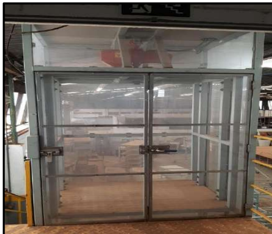
Elevador de carga
