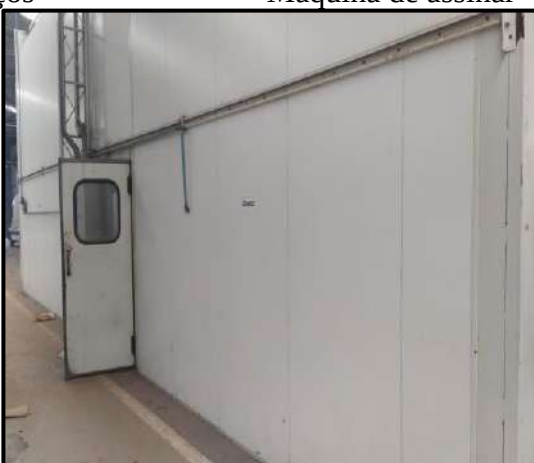
Lateral cabine de pintura
