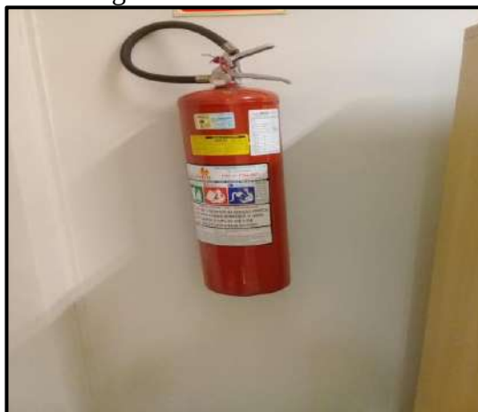
Extintor de incêndio
