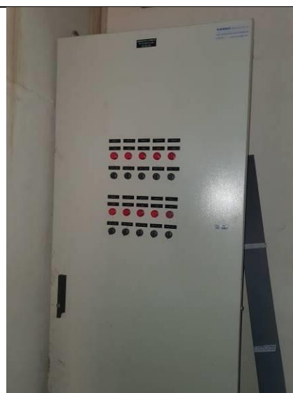
Item 4: Quadro de força e iluminação pré tratamento sebo, 220v.
