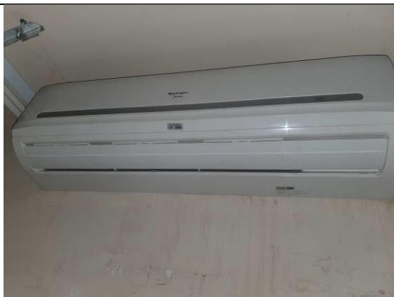
Item 12: Ar condicionado, marca Springer.
