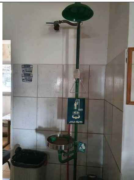
Item 11: Chuveiro de emergência, marca Avlis-Haws.
