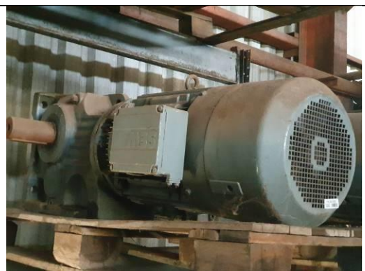
Item 44: Motor elétrico, trifásico, 10 cv, marca Weg, com redutor.
