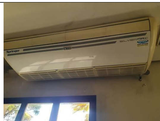
Item 15: Evaporadora de ar condicionado, marca Springer Silvermaxi.
