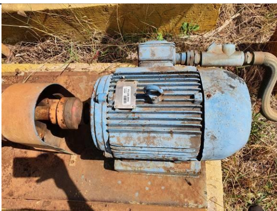
Item 4: Motor elétrico, trifásico, 10 cv, marca Weg com redutor.
