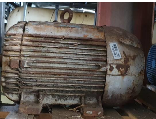
Item 77: Motor elétrico, trifásico, 25 cv, sem marca.
