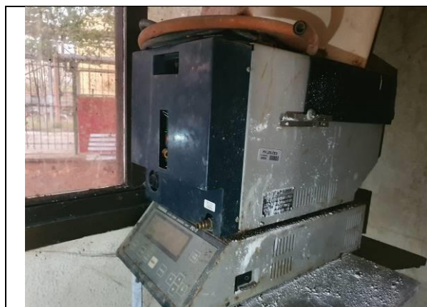
Item 6: Ponto de controle de fuga automatizado, marca Tanaka.
