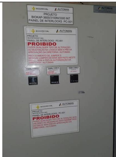
Item 24: Quadro de força, Projeto Biokap-3600/3100N/3300
