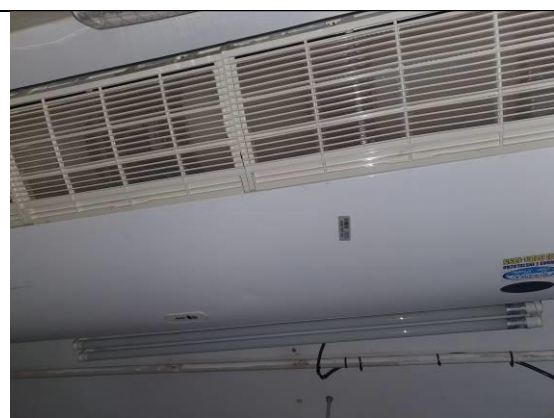
Item 18: Ar condicionado, sem marca.
