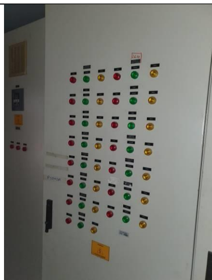
Item 8: Quadro de força Qdi 100, ácido graxo.
