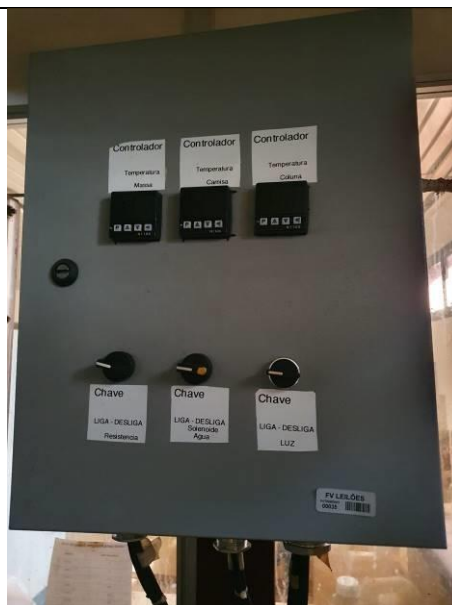
Item 22: Pannel de comando elétrico, sem marca.
