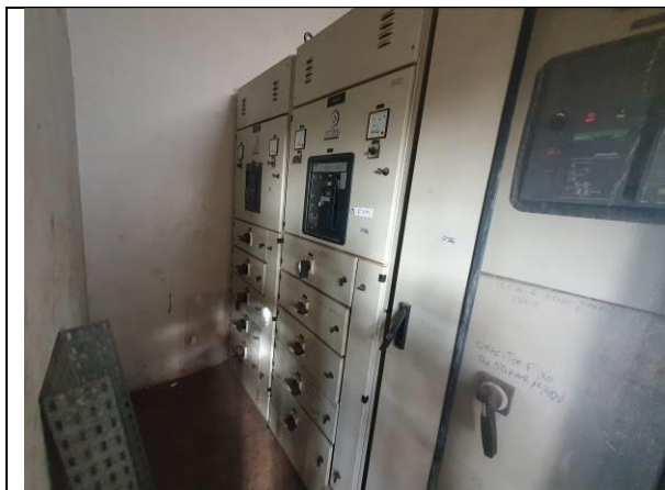
Item 1: Quadro de força, com capacitores fixos, e painel de comando.
