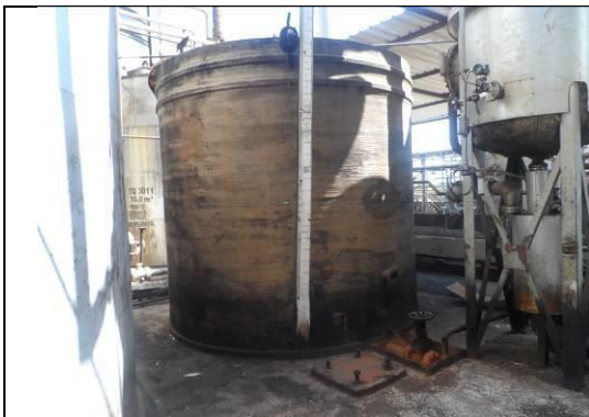
124- Tanque de fibra, cap. 15m³.
