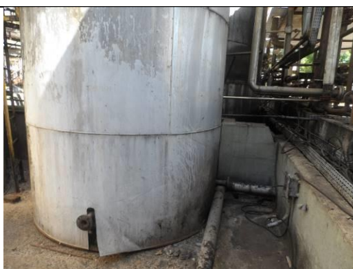
125- Tanque 3011, de aço de carbono com revestimento em amianto, cap. 10m³.
