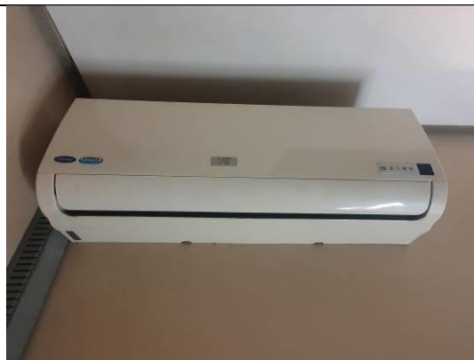
Item 4: Evaporadora de ar condicionado, marca Carrier.
