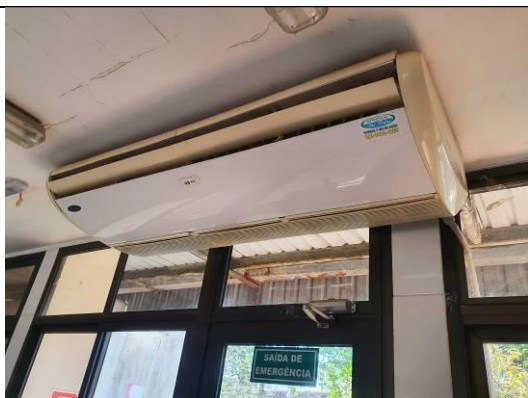
Item 9: Condensadora de ar condicionado, marca Carrier.
