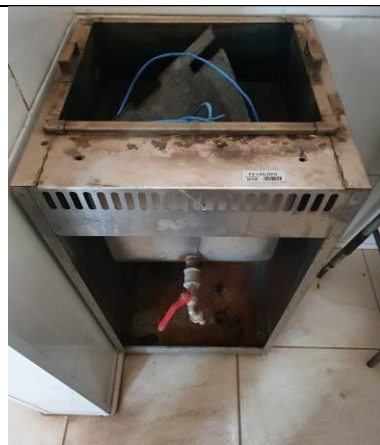
Item 22: Fritadeira industrial, sem marca.
