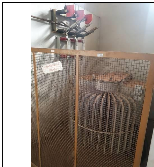
Item 2: Transformador trifásico a óleo, P-35.877 225Kva.
