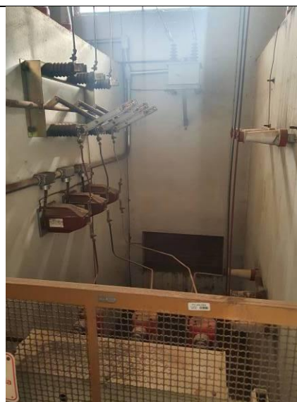
Item 3: Sistema de disjuntor de alta tensão, marca Aeg.
