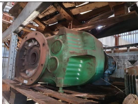
Item 78: Redutor acoplado em motor marca weg, 15 cv, trifásico.
