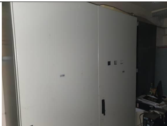
Item 19: Quadro de força, marca Yokogawa.
