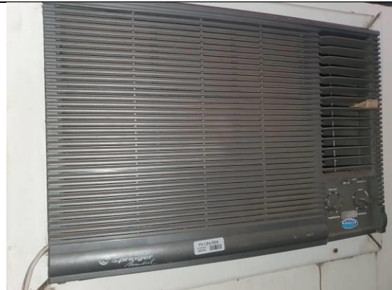
Item 7: Ar condicionado de parede, marca Springer 10500.
