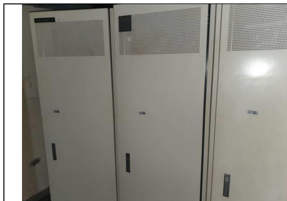
Item 19: Quadro de força, marca Yokogawa. Projeto secagem.
