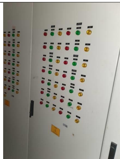
Item 10: Quadro de força CCM-5 Solventes.
