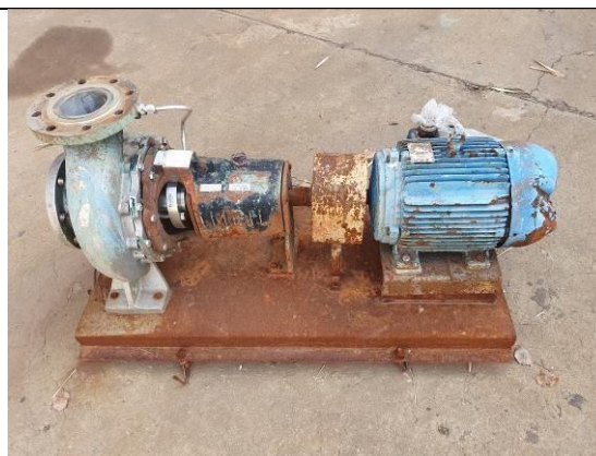
Item 16: Conjunto Moto-Bomba com motor marca Weg de 2 cv.
