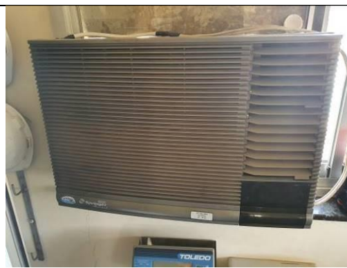
Item 17: Ar Condicionado de parede, marca Springer, 15000
