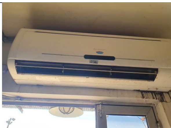
Item 10: Ar condicionado, marca Springer.
