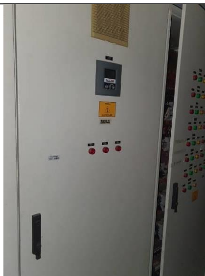
Item 7: Quadro de força com comandos elétricos, 440v.
