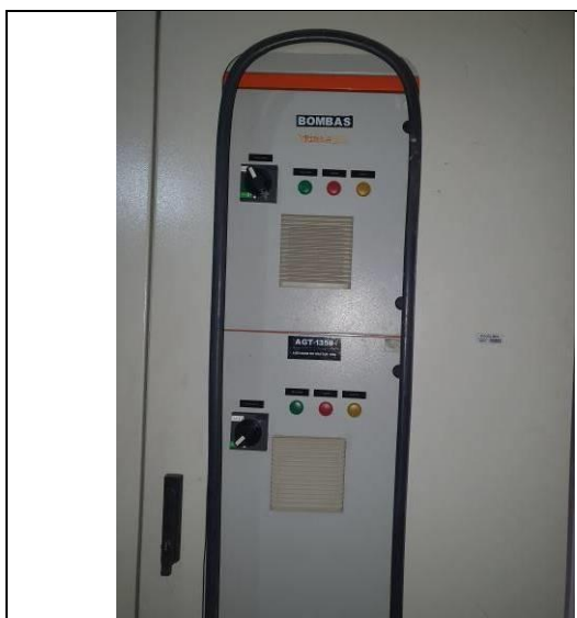
Item 3: Quadro de força AGT.1350 do Agitador do reator 1350 E bombas P1302A.
