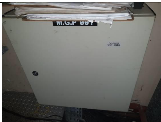
Item 25: Quadro de força MGP 001
