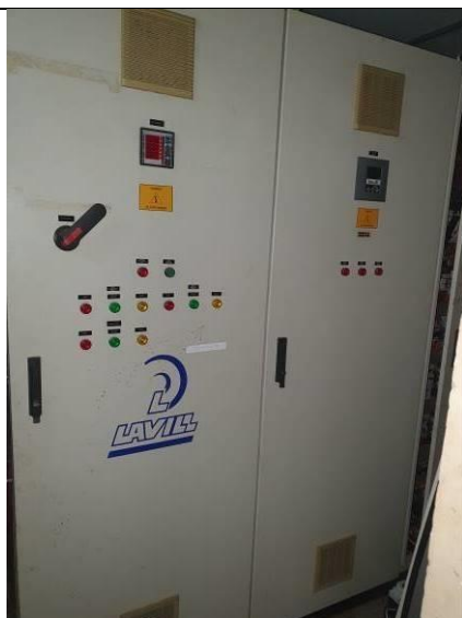
Item 6: Quadro de força ccm-4 plataforma de carregamento.
