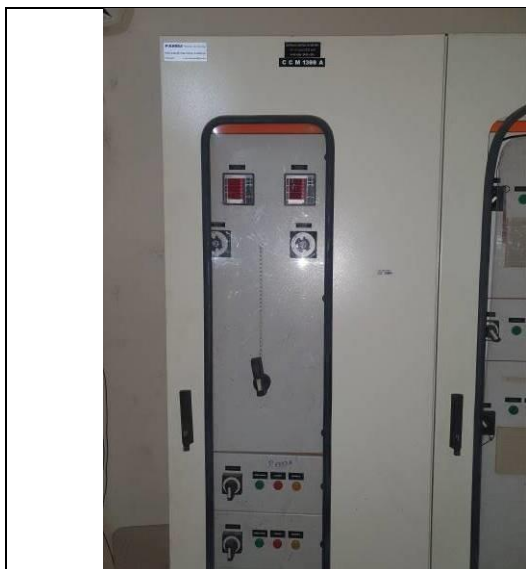
Item 1: Quadro de força centro de controle de motores ccm1300a. 440V.
