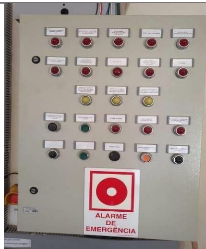
Item 7: Quadro de força.
